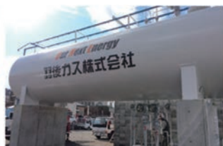
LPガス貯槽
