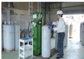
LPガス充填設備
