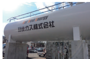
LPガス貯槽
