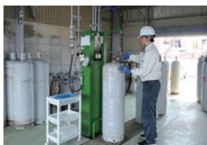
LPガス充填設備
